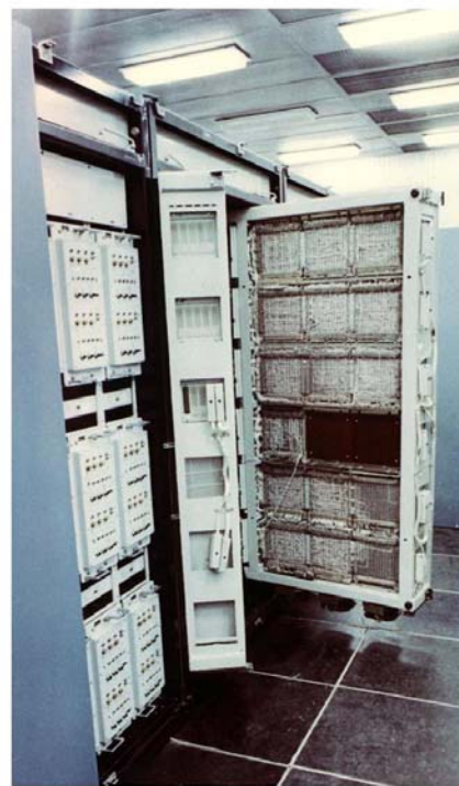
Рис. 5. Открытый шкаф МВК Эльбрус-2
